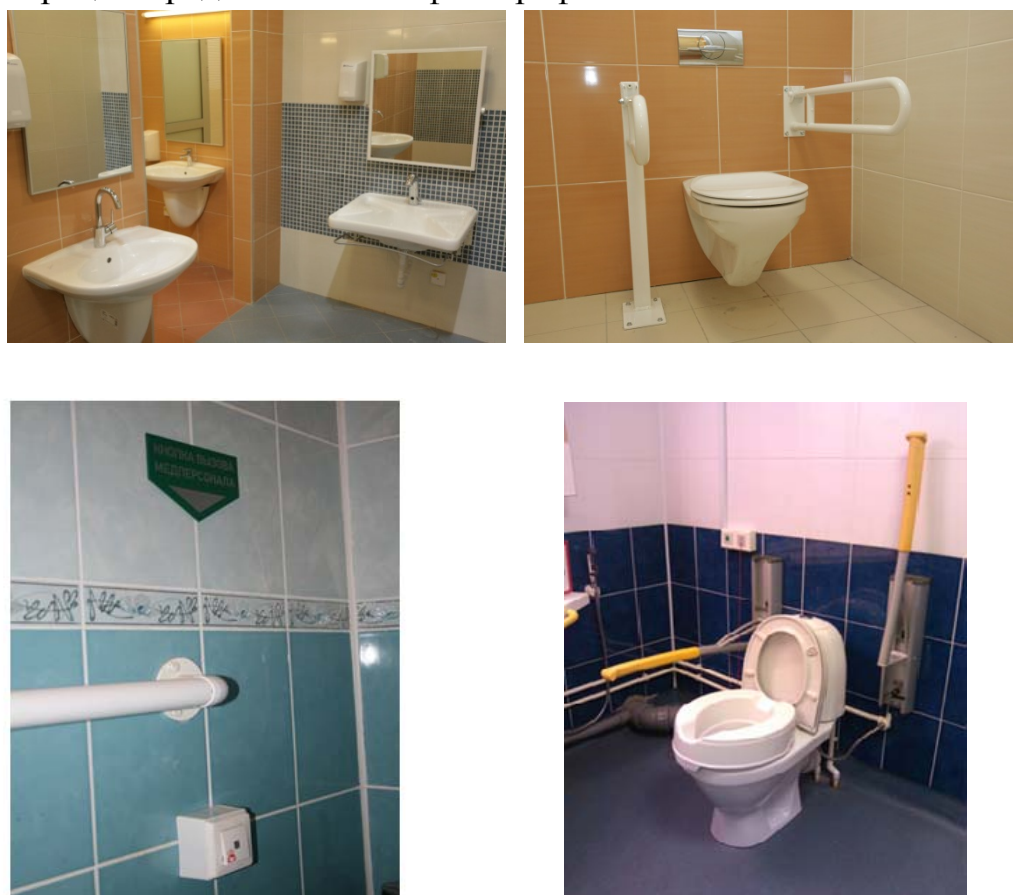
Примеры оборудования санитарно-гигиенических помещений 40
