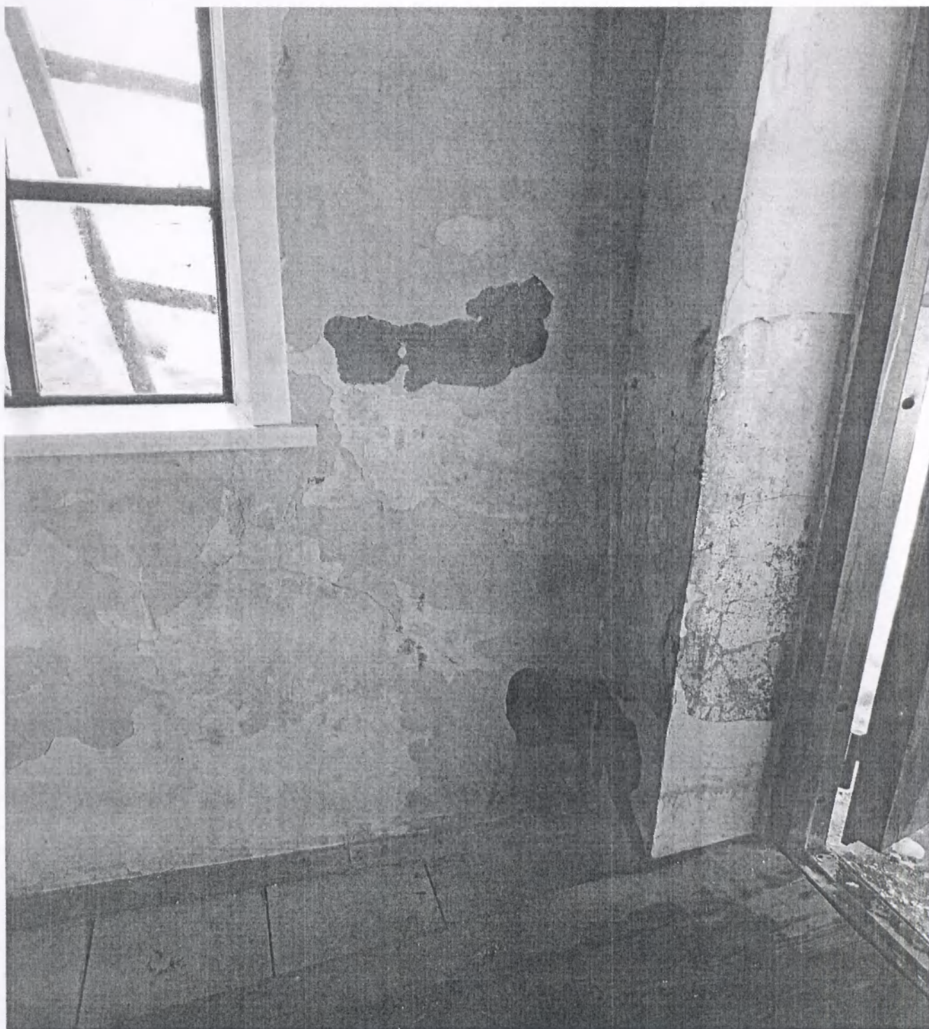
Фото № 5: Поверхность стен в тамбуре в банно-прачечном отделении не гладкая, имеются дефекты в виде отслоения, отпадения отделочного материала – водоземulsionной краски.
